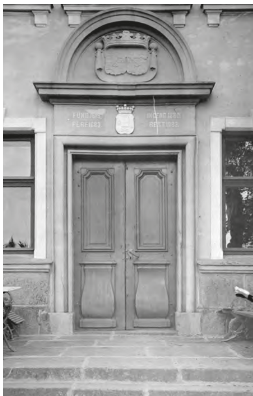
Sarvlaks huvudingång med byggherren Lorentz Creutz och hans fru Elsa Duvalls vapen, samt under dem det von Bornska vapnet som V.M. von Born lät sätta upp när byggnaden renoverades efter branden 1880. Foto: Svenska litteratursällskapet i Finland.
