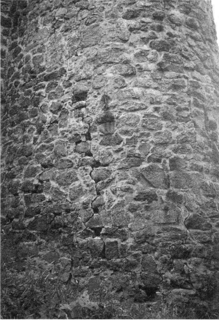
Kuva 14. Tornin halkeamat syksyllä 1991.
