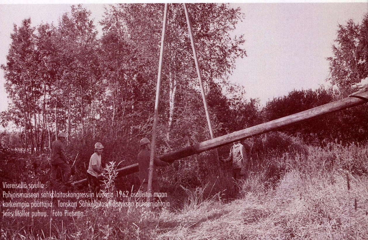
Maaseudulla jakelumuuntajarakennukset väistyivät pylväsmuuntajien tieltä rationalisointityön seurauksena.
