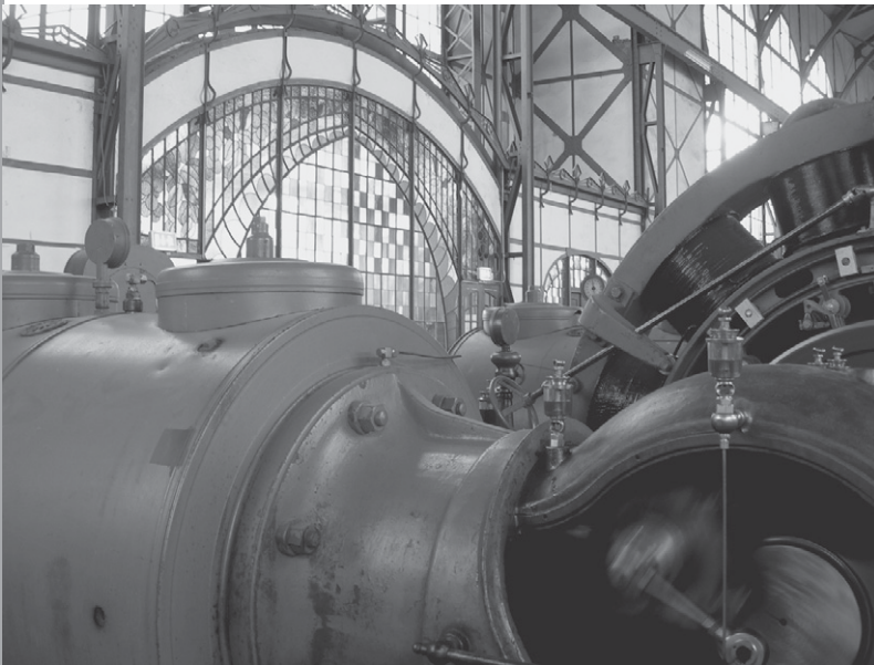
Zollern II/IV-kaivoksen konehuoneen laitteet ovat toimintakunnossa. Taustalla näkyvä koristeellinen jugend-henkkinen pääsisäänkäynti lasimaalauksineen ja teräskoristeineen korostaa konehuoneen merkitystä ja asemaa teollisuusrakennusten hierarkiassa. Kuva: Tuija Mikkonen.
