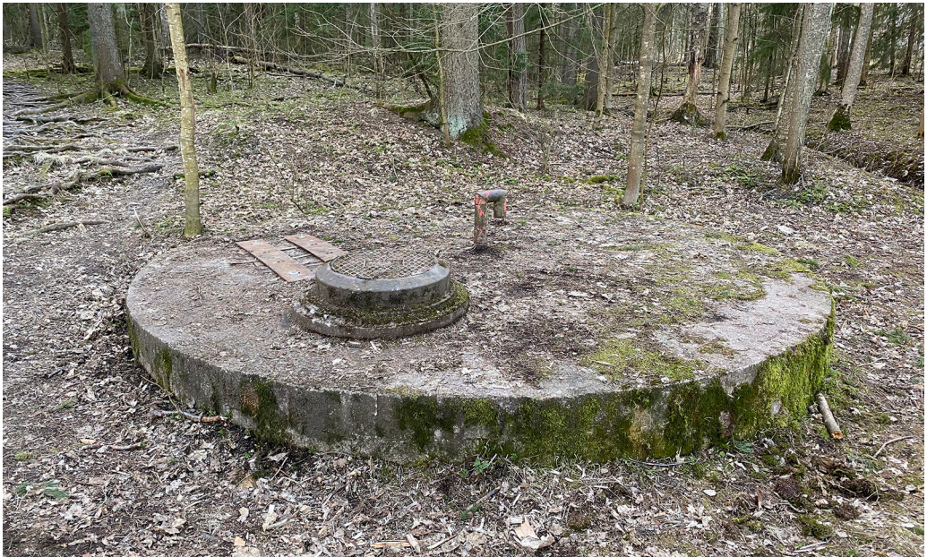
Kuva 4. Palokaivo Espoon Rastaalassa.
